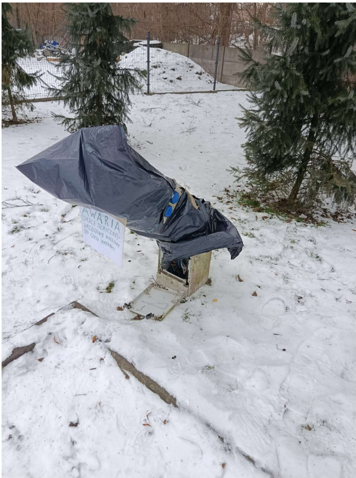
Uszkodzona rozdzielnia – słupek energetyczny
