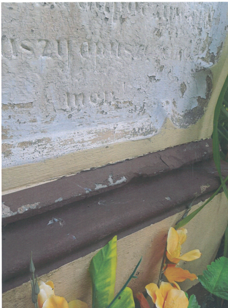
Fot. 8. Mszana, Kamienna kapliczka słupowa, zdjęcie uszkodzeń mechanicznych kamiennego profilu. Stan przed konserwacją, sierpień 2020 r.
